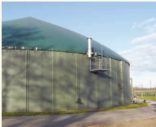
Die einzige Biogasanlage in Schleswig-Holstein, die von einer Kommune betrieben wird
